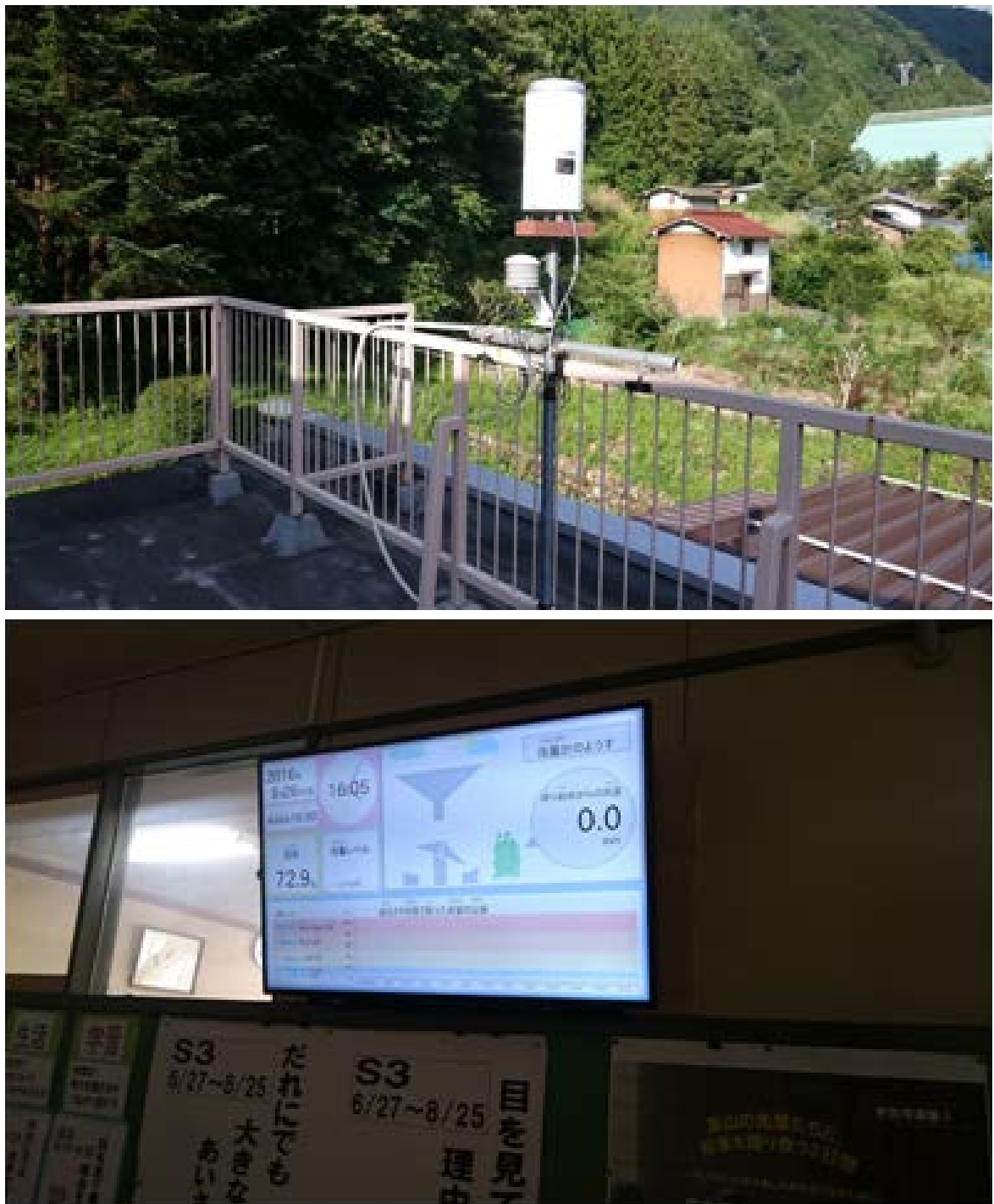
図-2.17 学習活動に使用する予定の設備 (上：屋上に設置した気象観測装置，下：職員室前の雨量表示・警報システム)
